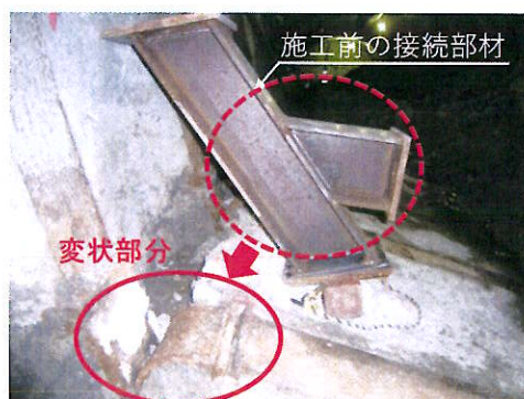
写真-2.1 下半支保工脚部での変状
